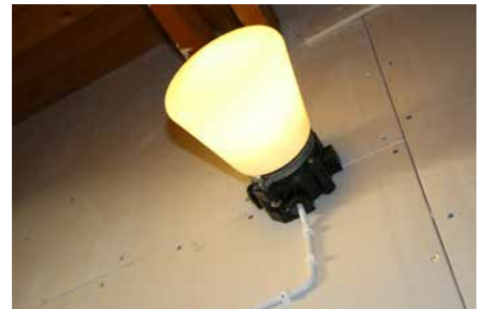
Tidstypisk bevarad armatur.
